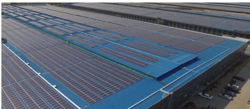
图 5.3-1 固定平铺式光伏方阵
