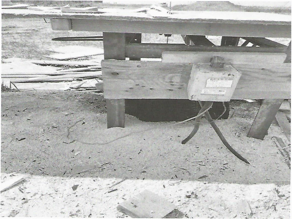
升压站木工锯台铁壳开关未接地，易造成漏电触电事故。
