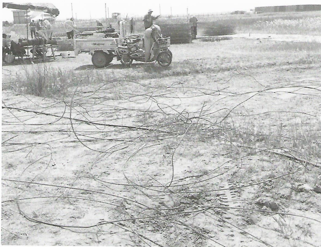
II 标钢筋笼制作区域，电缆与钢筋头未分开放置，易造成后续电缆保护层破坏，发生触电事故。
