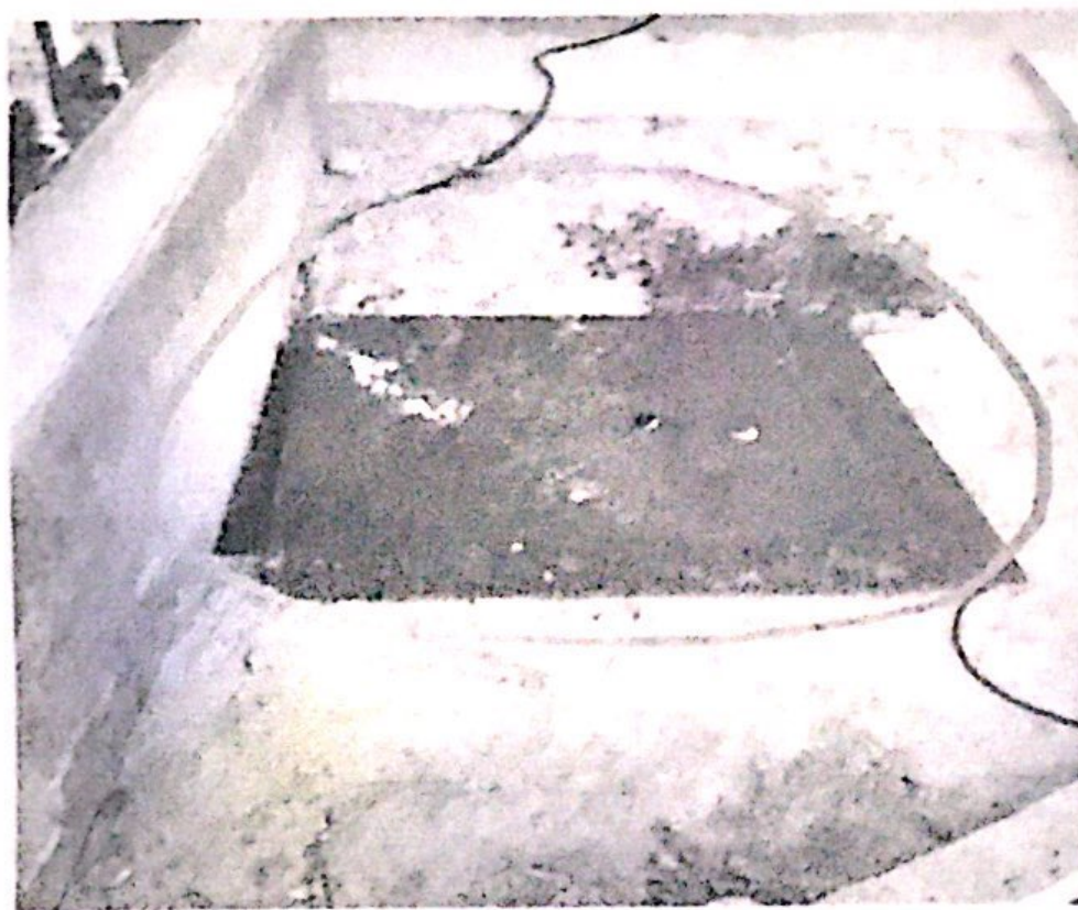
曲美项目电缆井基础未加盖井盖
